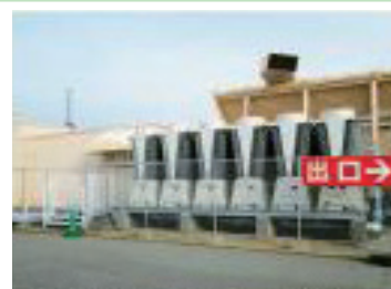
▲吸収式冷温水発生器をチラーに更新
