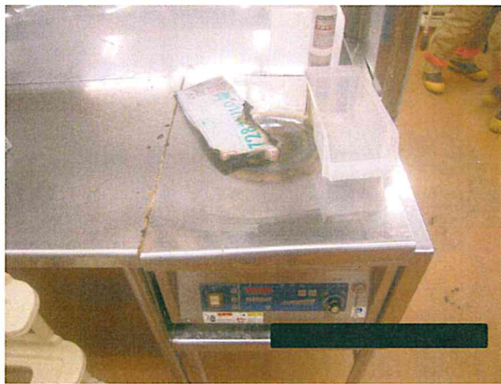
作業台(ステンレス製カバー設置)として使用していたIH調理器
